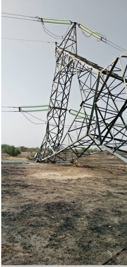
أبراج نقل الطاقة الكهربائية المستهدفة
